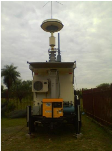
Estaciones portables TMS 01, TMS 02 y TMS 03.
